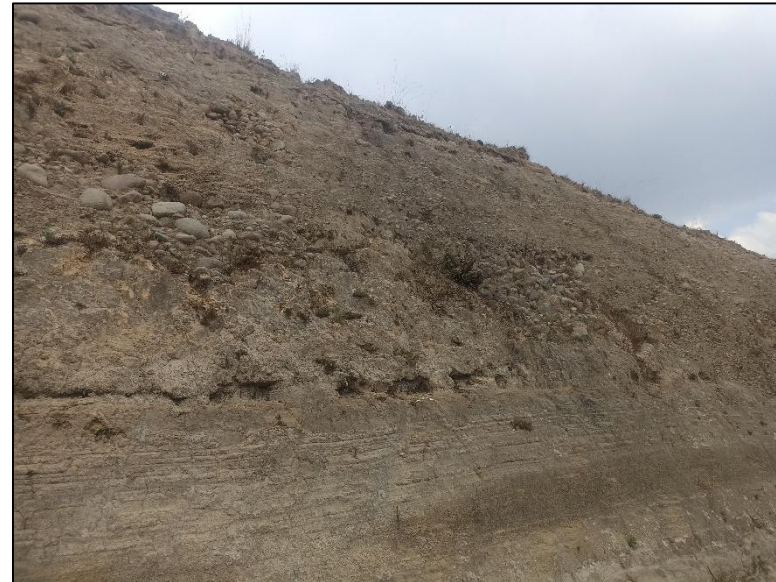
Fotografía 18. Material granular propenso a caer.
