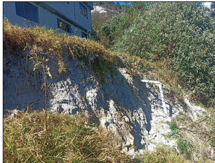
Fotografía 65. Material alterado con grietas.
