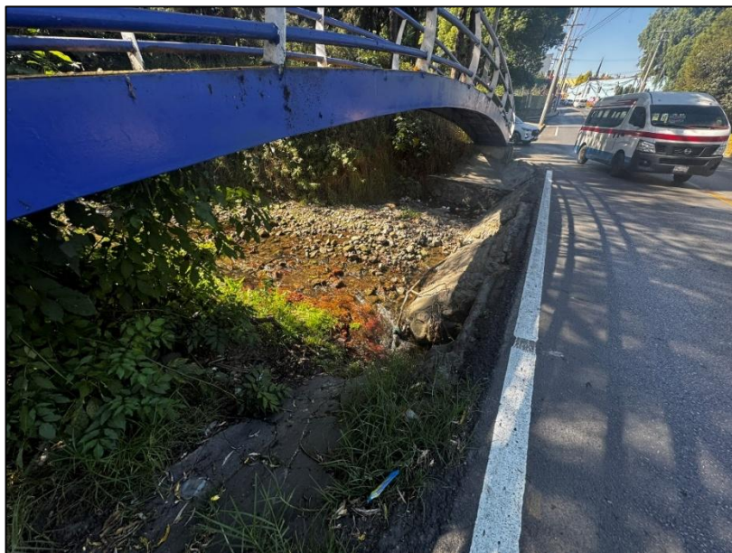
Fotografía 70. Puente alcantarilla con paso comprometido.
