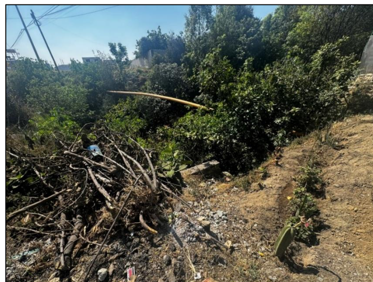
Fotografía 11. Cruce aéreo de gasoducto 8".
