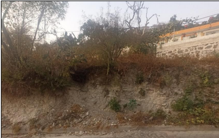
Fotografía 27. Material con caído en la base del talud.
