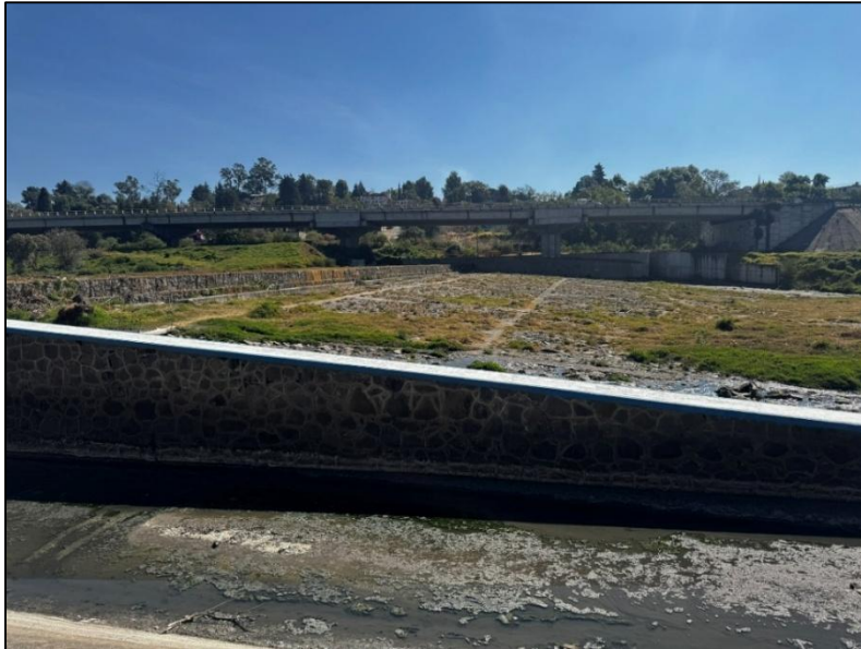
Fotografía 74. Estructura para control y derivación de gastos.
