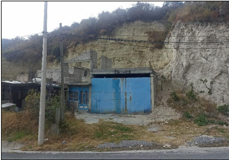
Fotografía 3. Material inestable propenso a caer sobre viviendas.
