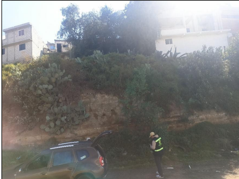
Fotografía 15. Tobas con estratos blandos fácilmente erosionables, con desprendimientos.
