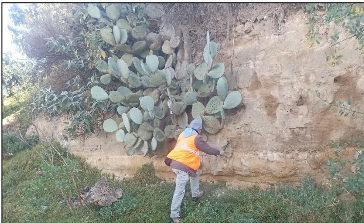
Fotografía 13. Tobas altamente erosionables con intercalación de material duro y blando.
