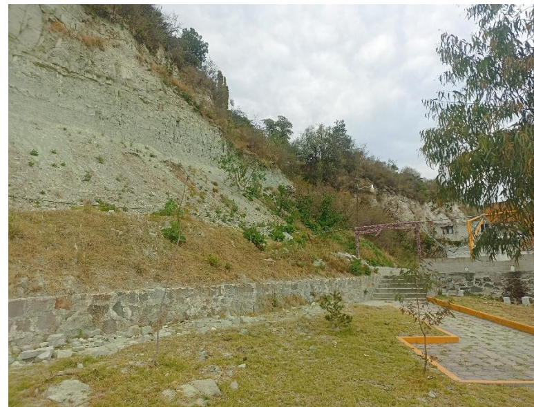
Fotografía 6. Material inestable propenso a caer sobre canchas.
