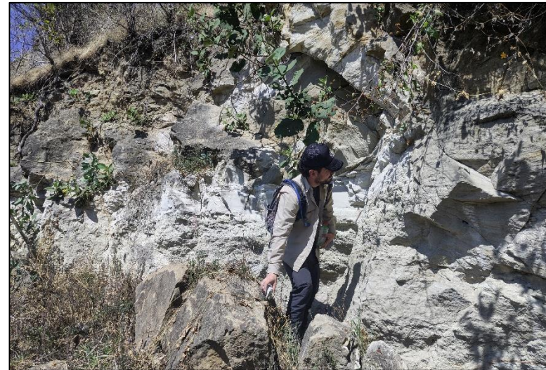
Fotografía 32. Caída de bloques.
