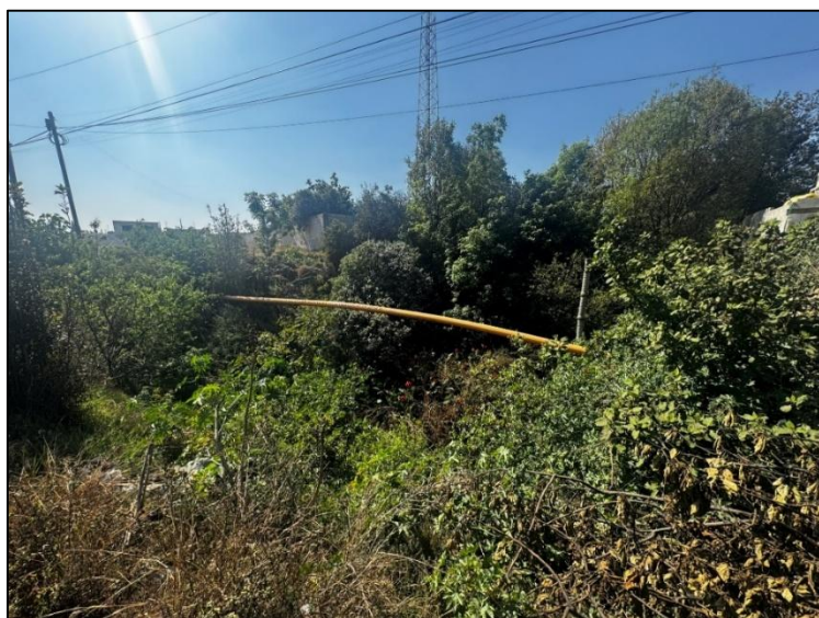
Fotografía 10. Cruce aéreo de gasoducto 8".
