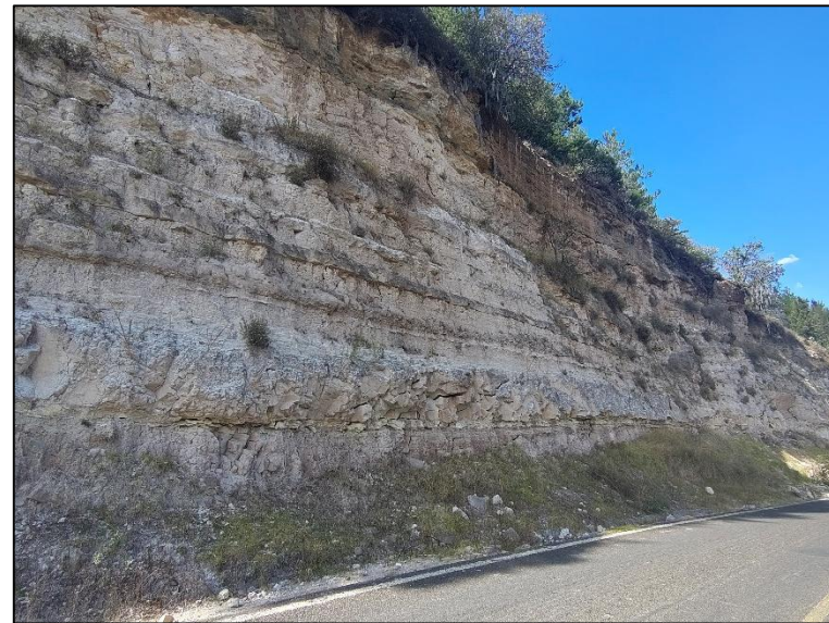
Fotografía 62. Estratificación incipiente de materiales blando y duros provocando caídos.
