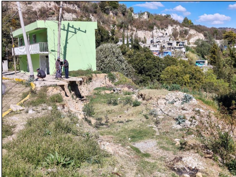
Fotografía 63. Material lacustre alterado y colapsado.
