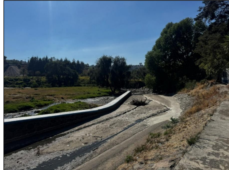
Fotografía 75. Estructura para control y derivación de gastos.
