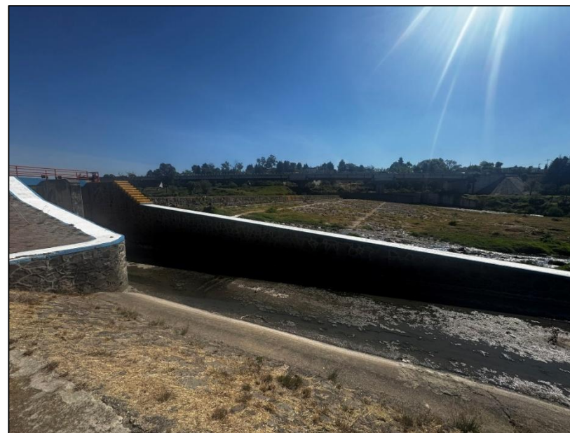
Fotografía 73. Estructura para control y derivación de gastos.
